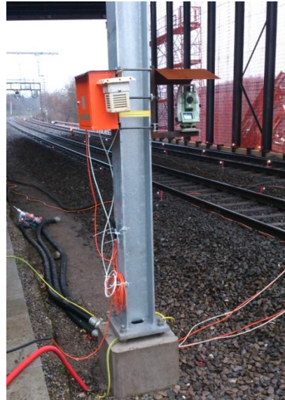
Tachymeter an Fahrleitungsmast
